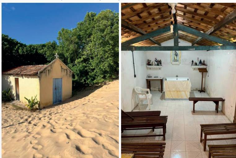
Figura 1 e 2: Interior e fachada da Capela de Nossa Senhora Imaculada Conceição e o avanço das dunas na Capela. Comunidade remanescente de quilombo Pixaim, município de Piaçabuçu, Alagoas. 2025.
