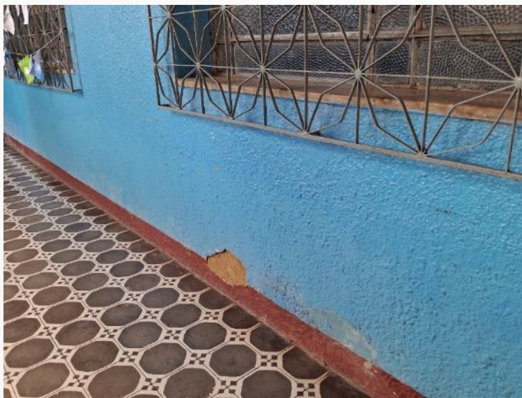
Figura 19 - Parte de um dos corredores da edificação nonde foi possível perceber que os mosaicos de revestimento do piso são muito antigos.
