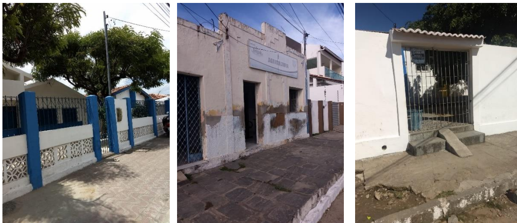
Figura 09, 10 e 11 – Imagens de edificações que não apresentam rampas na área em estudo.
