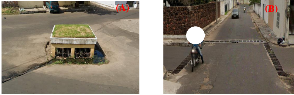
Figura 4 – (A) Poço de visita e (B) Galerias para coleta da água pluvial.
