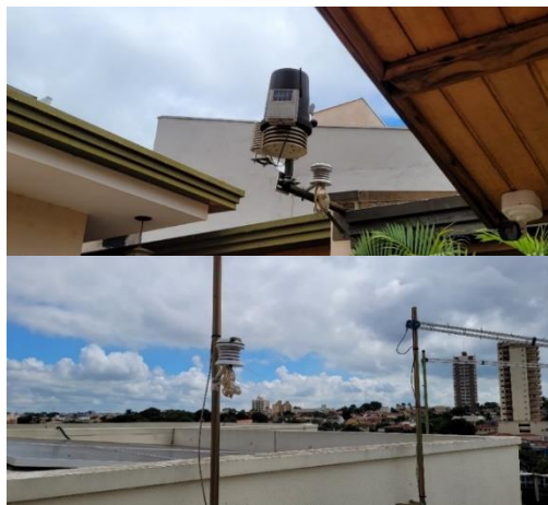
Figura 1 – Sensores instalados no ambiente urbano; próximo à superfície (primeira imagem) e a cerca de 15 metros de altura (segunda imagem).
