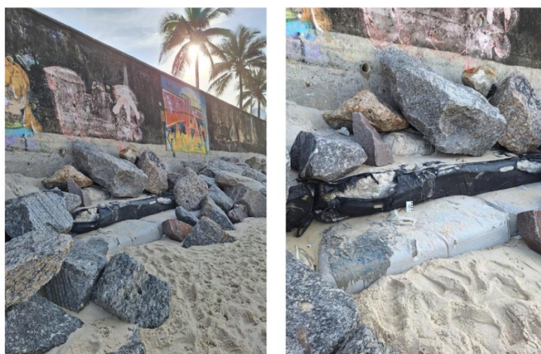
Figura 5. Blocos de rocha e bolsas de concreto encontradas próximas ao muro no P02. Fonte: autora, 2024.
