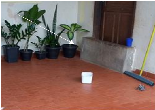
Figura 2: Muro de contenção na porta de uma casa do bairro Cohab Velha.
