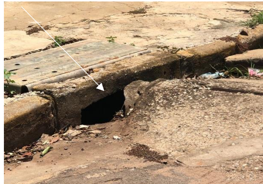
Figura 3: Obstrução de bueiro por outra obra de drenagem.
