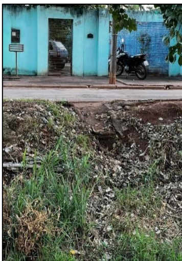
(A) Desbarrancamento do bueiro
