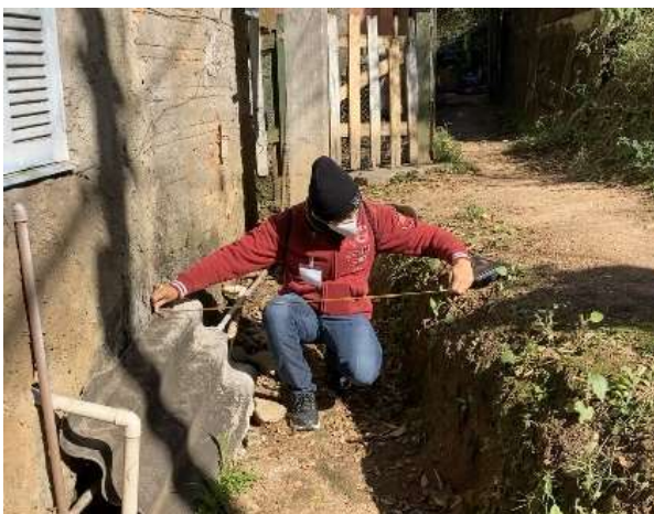
Figura 1: Registro fotográfico durante a avaliação de risco em uma moradia na Comunidade da Servidão dos Lageanos em 2021, quando existiam dois taludes de corte, um distando da moradia um com 1,05m e outro com um muro de contenção acima, distando do primeiro 1,20m. Como resultado o muro de contenção distava 2,25m da moradia.
