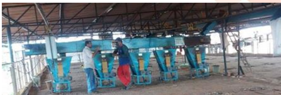
Figura 04 – Sistema de alimentação dos fornos
