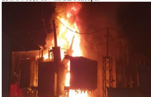
Figura 1 – Incêndio no transformador TR2 230/64/13,8 KV na SE Macapá.
