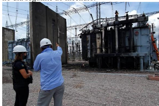
Figura 2 – Transformador TR2 230/64/13,8 KV no dia seguinte ao incêndio.
