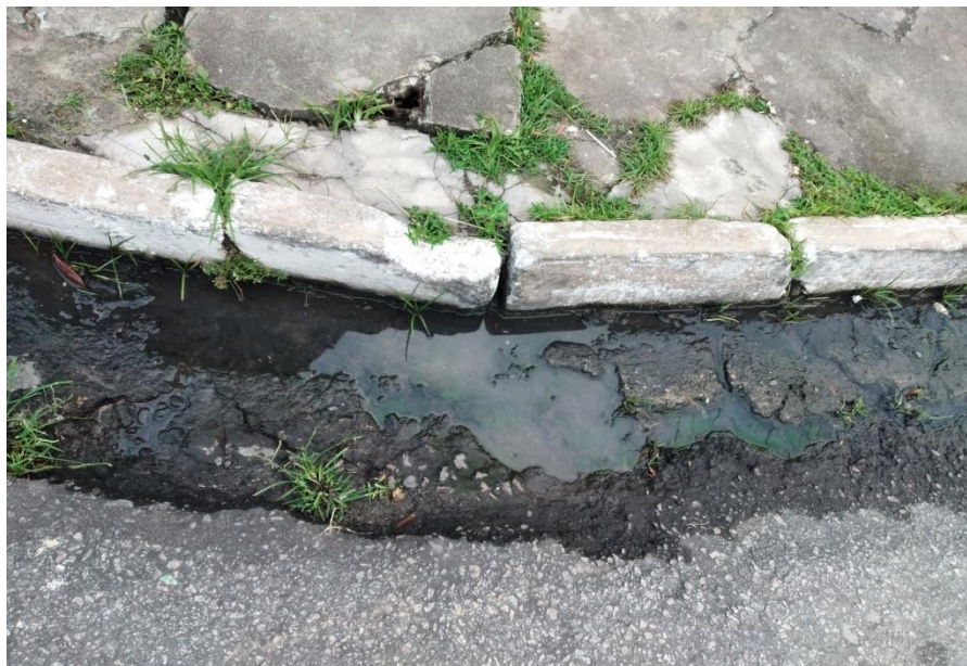
Figura 5. Esgoto in natura a céu aberto.
