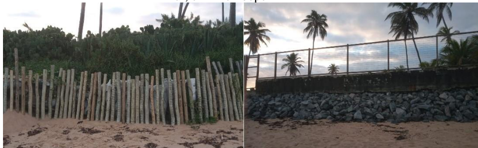
Figura 6 - Obras de proteção em áreas susceptíveis à erosão na Praia do Piruí, em Arembepe
