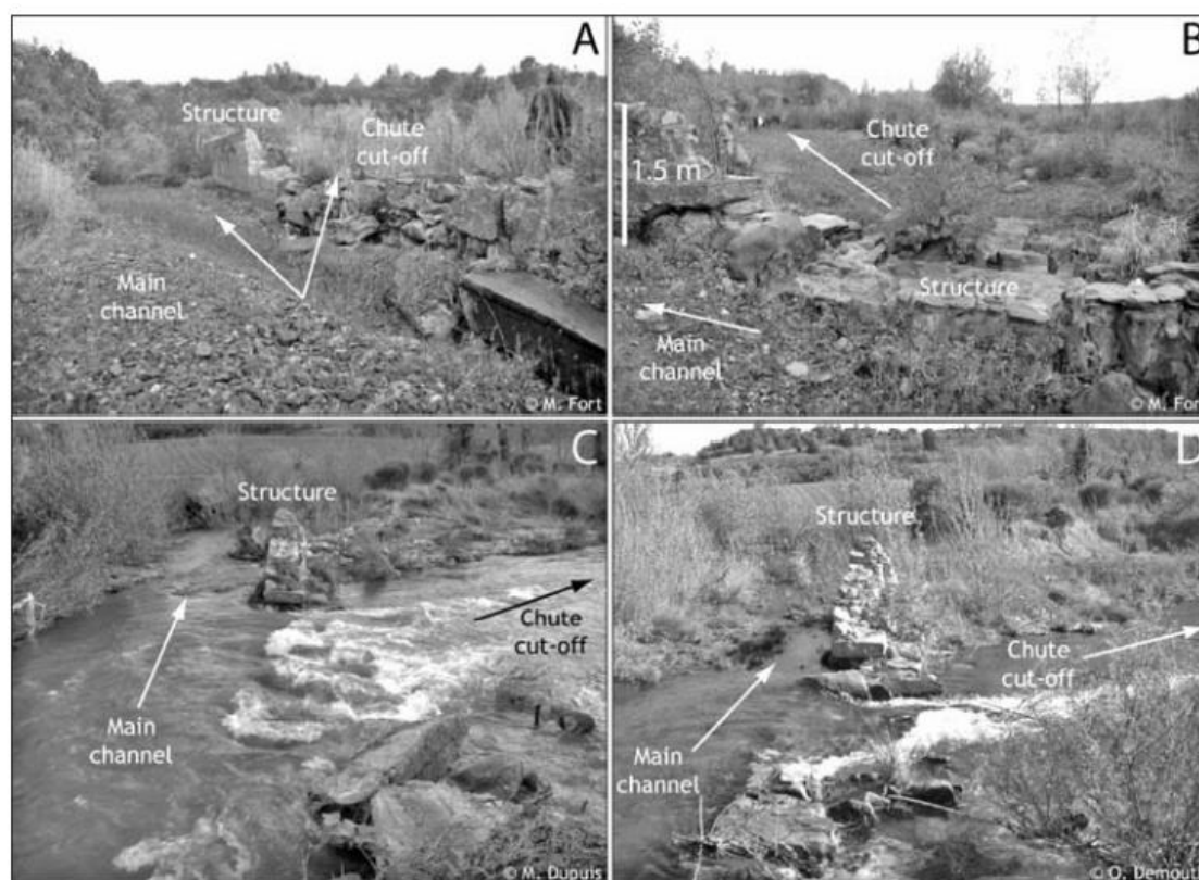
Figura 1. Corredor erodível (Rio Clamoux -França)
