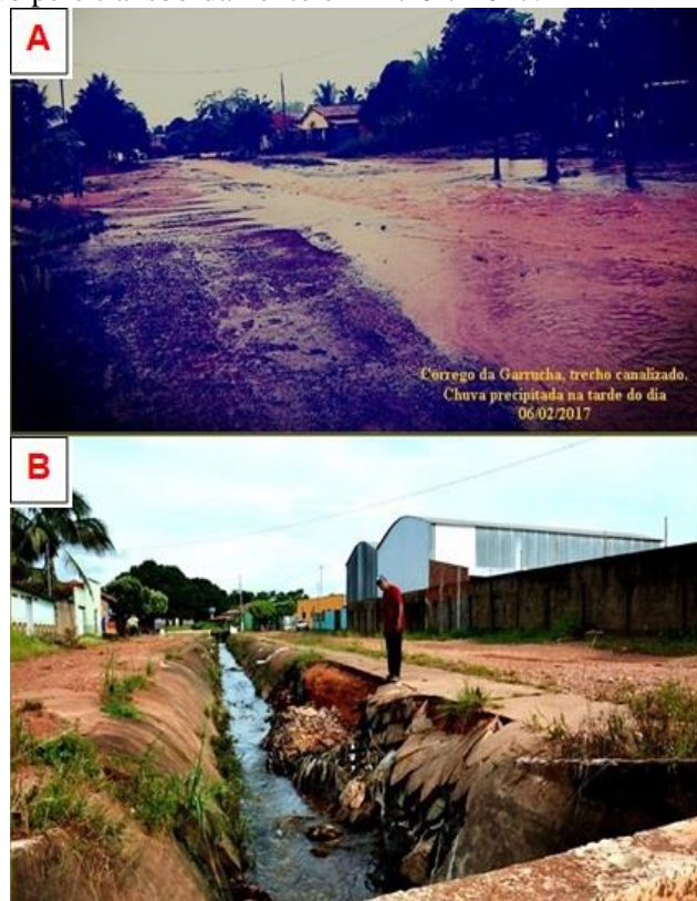
Figura 4. A) Transbordamento em trecho canalizado no córrego da Garrucha em 06/02/2017; B) Mesmo trecho danificado pelo transbordamento em 11/ 02/ 2017.
