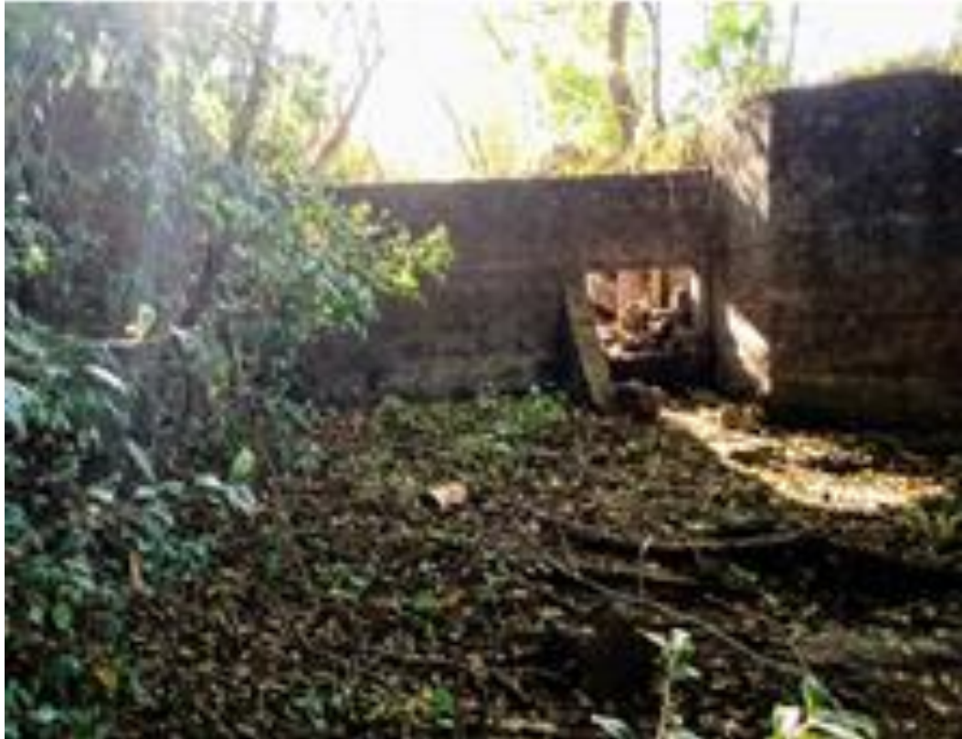
Figura 5: Ruínas do registro de parada. Data: maio de 2021.
