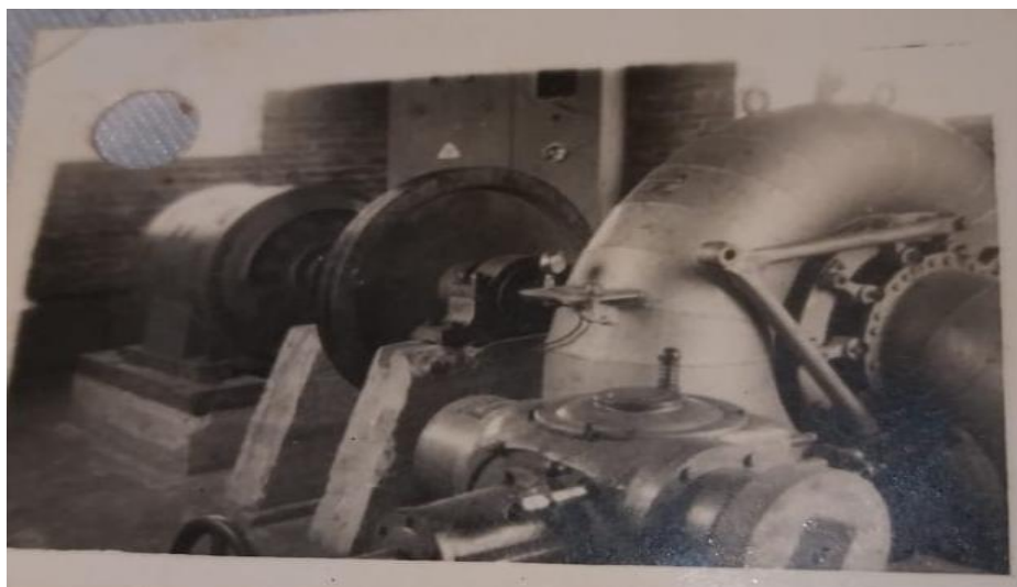
Figura 7: Registro fotográfico da turbina da mini usina hidrelétrica de Maripá. Gentileza de Durval Conci.
