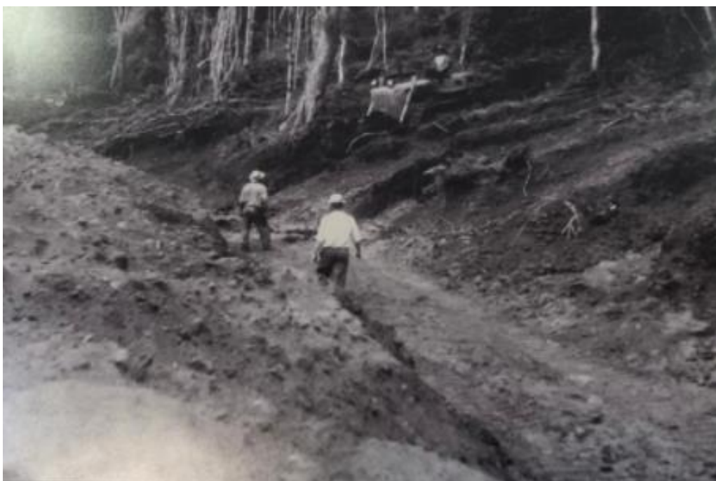
Figura 4: Construção do canal de adução. Data: 8 de fevereiro de 1967. Gentileza de Durval Conci.
