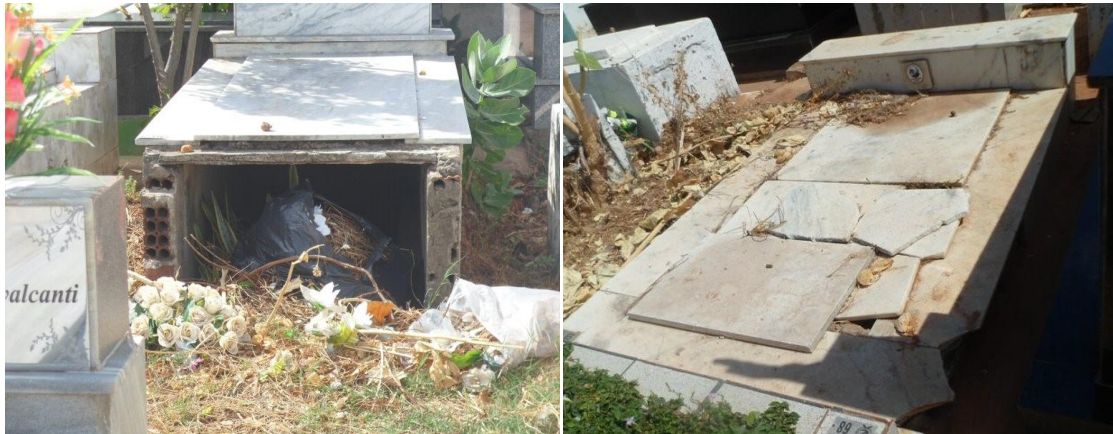
Figura 3: Integridade dos túmulos do cemitério São Sebastião na zona urbana de Mossoró/RN. Fonte: Aatoria (2020).
