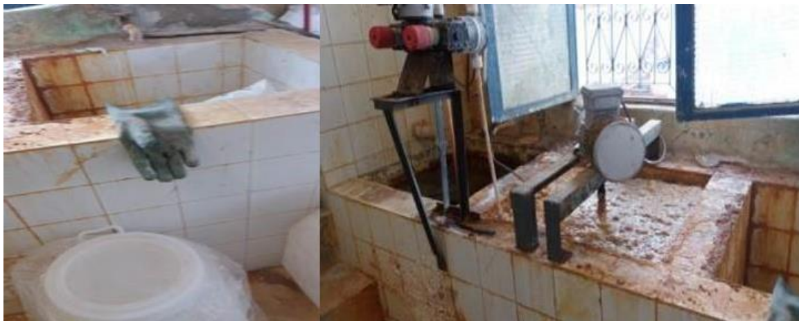
Figura 1. Local destinado para uso do cloro (esquerda) e sulfato de alumínio (direita)
