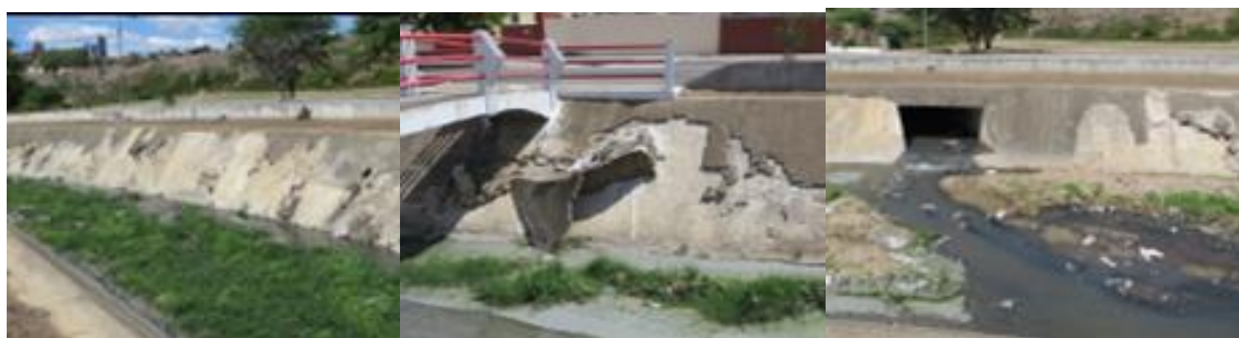
Figura 3 – Situação da infraestrutura do canal do riacho Bodocongó, PB.
