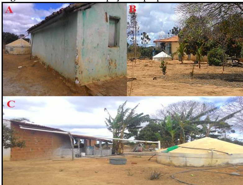
Figura 6: Cisternas em espaços inapropriados
