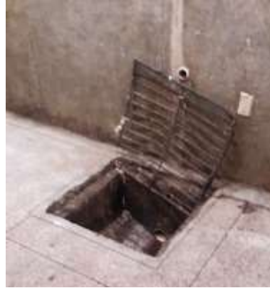
Imagem 3: Sistema de escoamento para sangue e água de higienização
