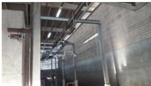
Imagem 2: Sistema de escoamento para sangue e água de higienização
