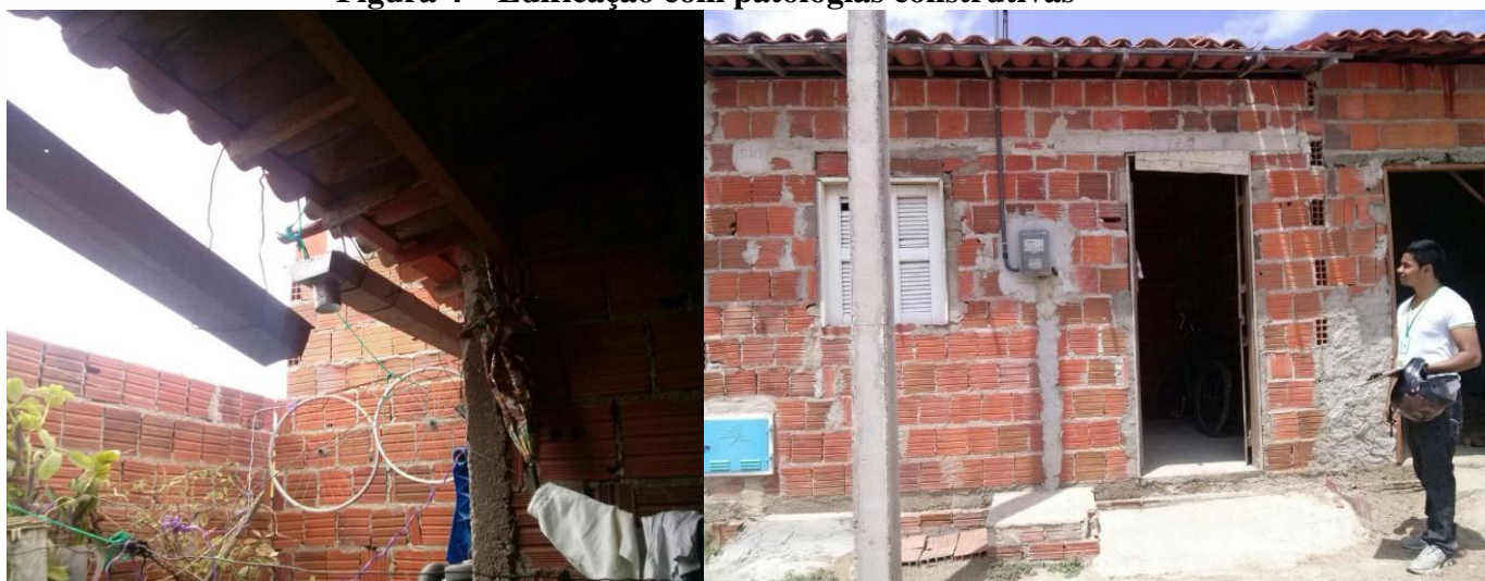
Figura 4 – Edificação com patologias construtivas
