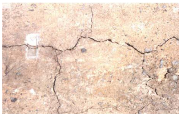
Figura 2 - Detalhe das fissuras mapeadas no topo do pilar – Usina de Furnas [HASPARYK, 2005].
