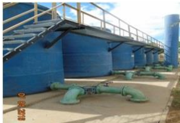
Figura 02: Estação de tratamento de água Compacta.
