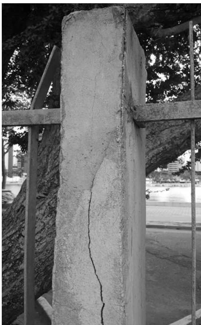
Figura 3: Pilar com patologia de comprometimento estrutural (fonte do autor)
