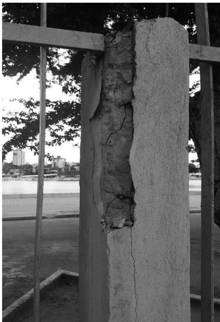
Figura 2: Pilar com patologia de efeito estrutural (fonte do autor).
