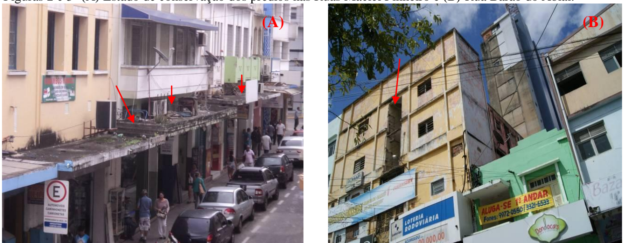
Figuras 2 e 3- (A) Estado de conservação dos prédios nas Ruas Maciel Pinheiro e (B) Rua Barão do Abiai.
