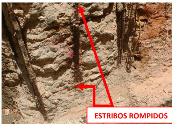
Figura 2: Pilar com detalhe de corrosão acentuada e estribos rompidos
