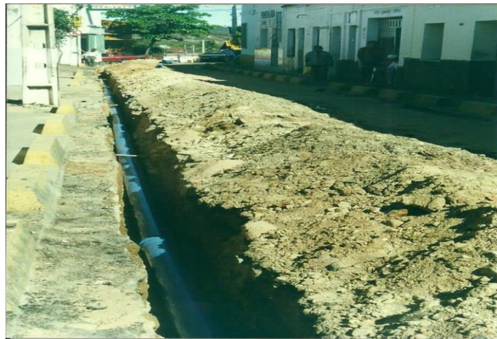
Figura 4 Obra de ampliação da rede de distribuição de água encanada em Jucás no ano de 1998.
