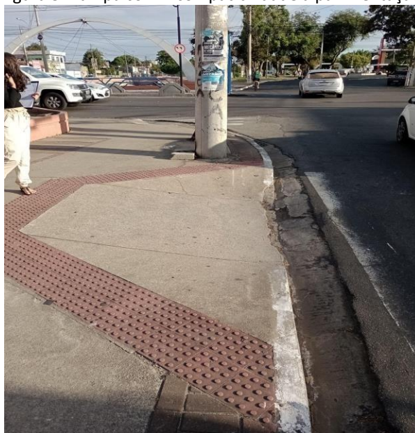
Figura 5: Rampa com incompatibilidade a pavimentação.
