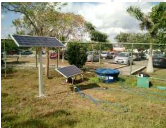
Figura 2: Sistema de bombeamento
