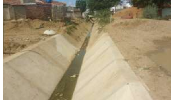
Figura 5: Canal de separação do esgoto das galerias
