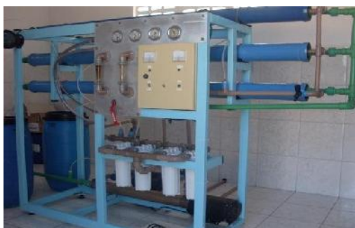
Figura 2.Equipamento instalado na Agrovila 8 – Ibimirim- PE
