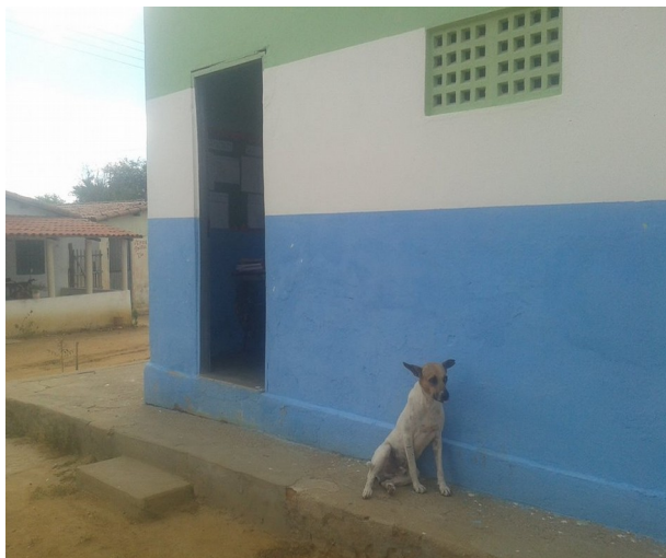
Figura 05: Porta da entrada da sala de aula inacessível para deficientes físicos na Unidade de Ensino Santa Luzia – Rafael Fernandes/RN
