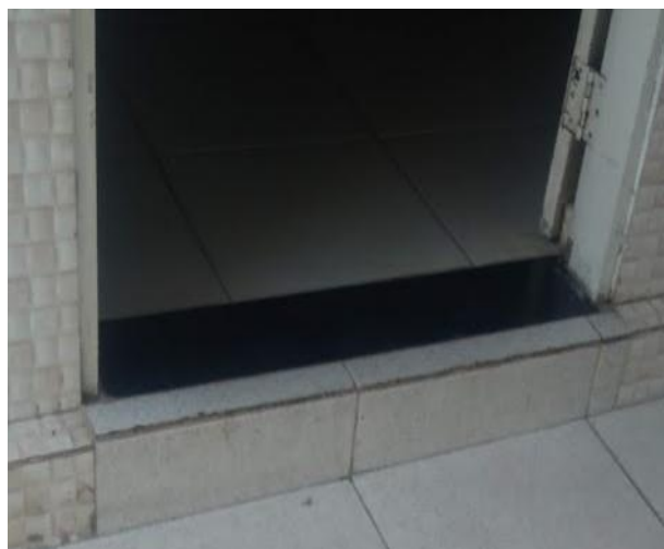
Figura 4- Batente da Porta da Sala de Direção: Escola I
