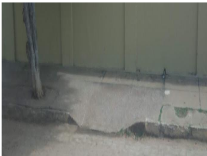
Figura 7- Rampa de Acesso a Calçada: Escola IV
