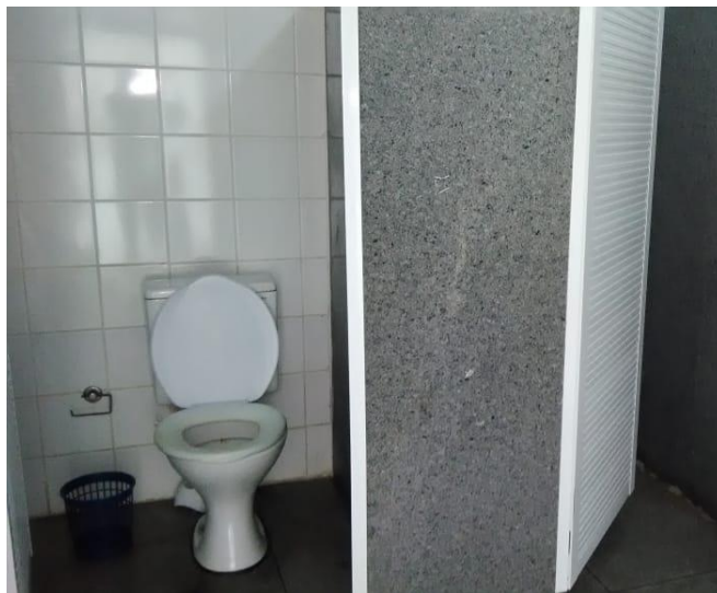
Figura 5- Portas dos banheiros e a falta de barras de apoio: Escola II
