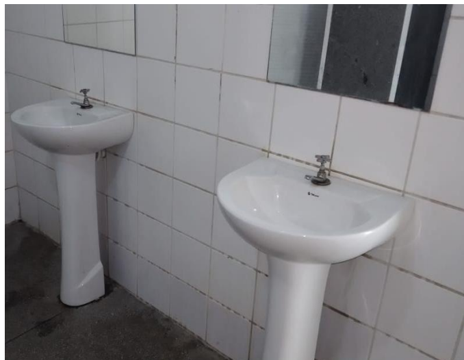
Figura 6- Lavatório sem barra de apoio: Escola II
