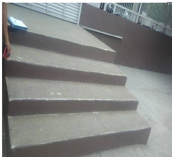
Figura 2- Escada sem Nenhum Tipo de Proteção: Escola III
