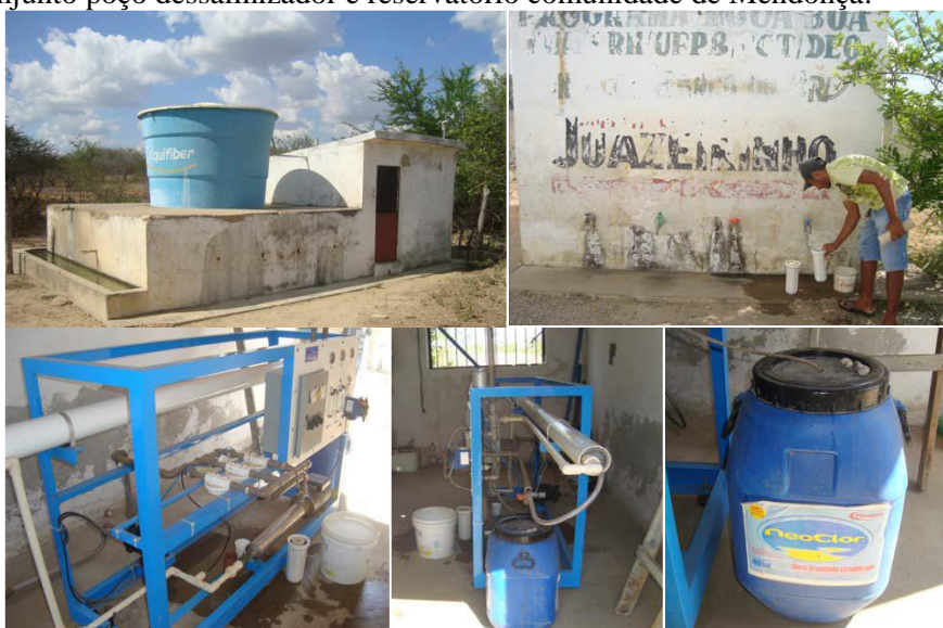
Figura 1: Conjunto poço dessalinizador e reservatório comunidade de Mendonça.
