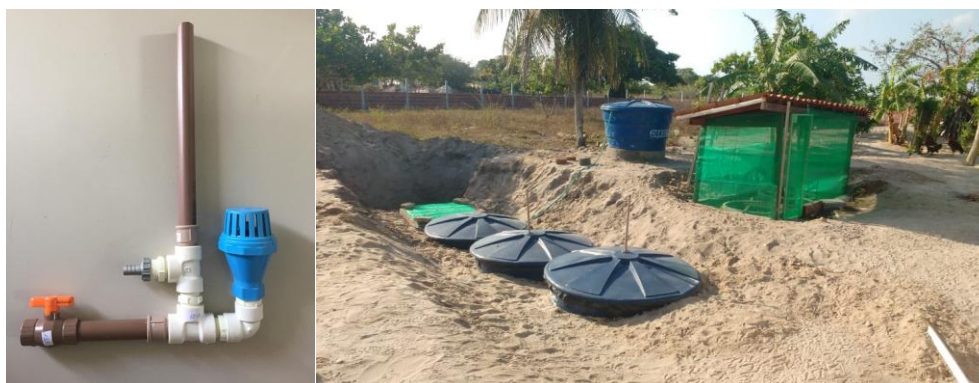
Figura 4: Bomba carneiro montada e montagem final do sistema bioágua e fossas biodigestoras
