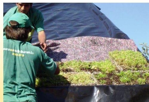
Figura 2 – Colocação da membrana de retenção de nutrientes e módulos Ecotelha. Fonte: https://goo.gl/ouQEhi
