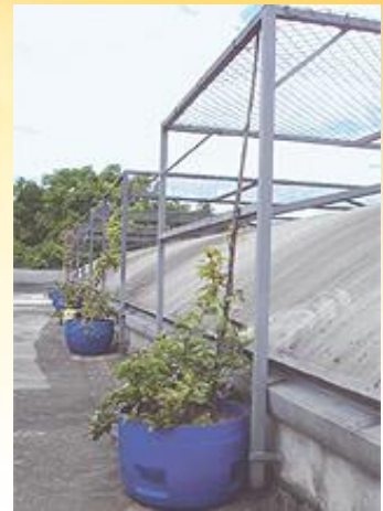
Figura 10 – Aplicação de cobertura verde aérea na Faculdade de Saúde Pública (FSP) da USP.
