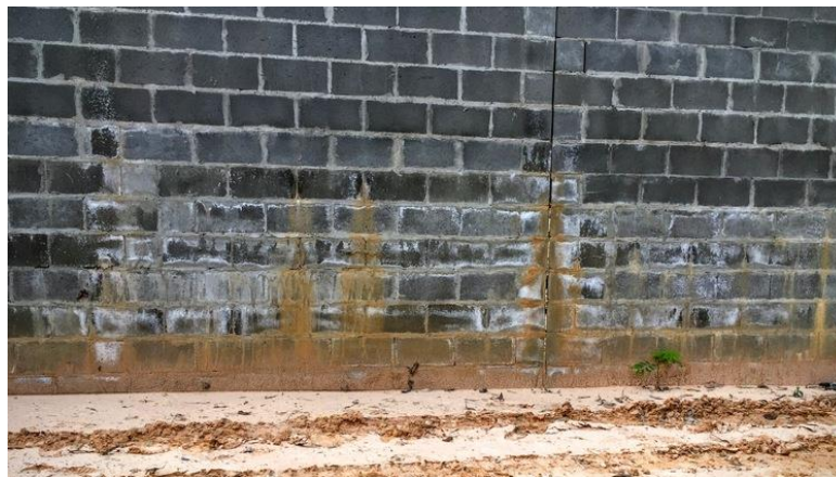
Figura 2- Eflorescências nas alvenarias em estruturas de concreto armado
