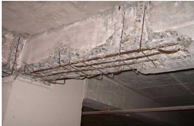
Figura 3- Desagregação de uma viga em estruturas de concreto armado
