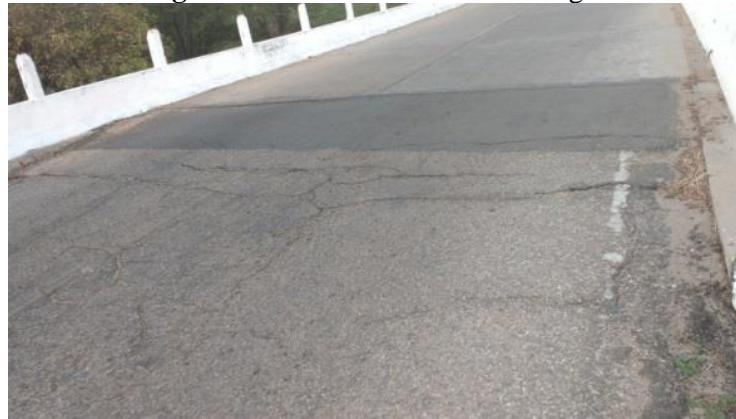
Figura 7 – Trincas Transversais Longas
